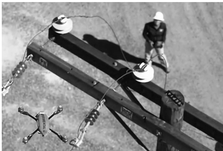
Rys. 3. Kontrola sieci NN przez BSP. Fot. Źródło SDG&E
